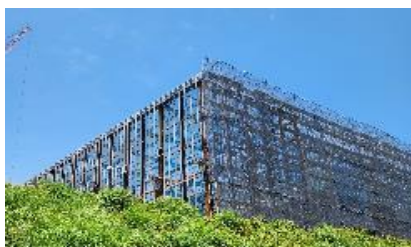
鉄骨建方工事 柱 や梁などの建物の骨組みを、 鋼鉄製の部材を用いて建てる（鷹工）
