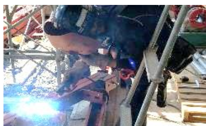
鍛冶工事 作業風景 耐 震・耐久性など構造物を安定させる土台となる工事
