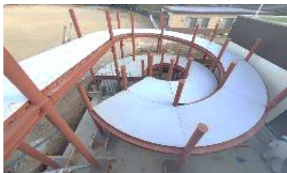
外部階段製作工事 鉄 骨や建築に利用する金属を加工することで、用途に合った形にする
