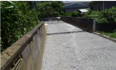
Y様邸車庫土間コンクリート工事 基礎砕石・ワイヤメッシュ敷設
