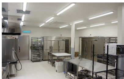
那珂川キッチン第2工場 工場内風景
