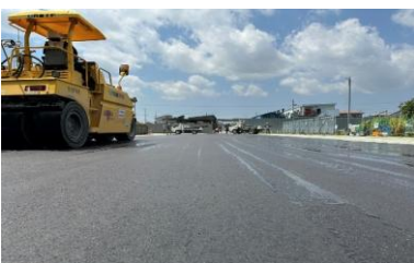
舗装工事の風景です。 車道や敷地内の整備を実施します。
