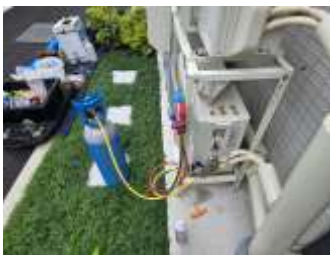
空調機点検・修理をお願いします。
